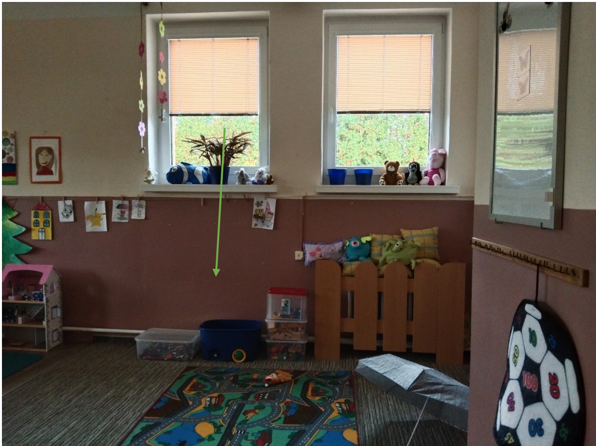
Obrázek 3 Přesun radiátoru – topení úprava trubek – nevhodné řešení
