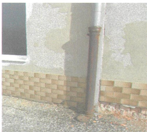
(typické provedení zaústění dešťových svodů na budovách A až G přímo do potrubí areálové kanalizace)
