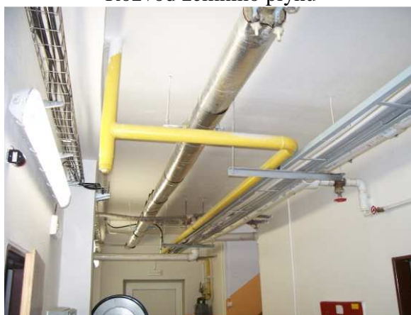
Rozvod zemního plynu
