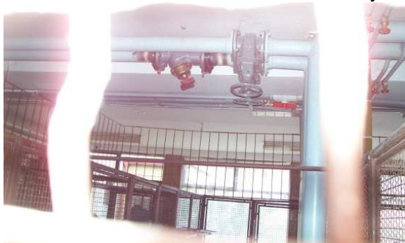
Rozvody ústředního vytápění
