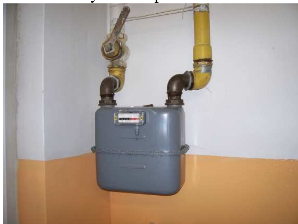
Plynoměr v pavilonu A
