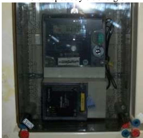
Měření spotřeby el. energie
