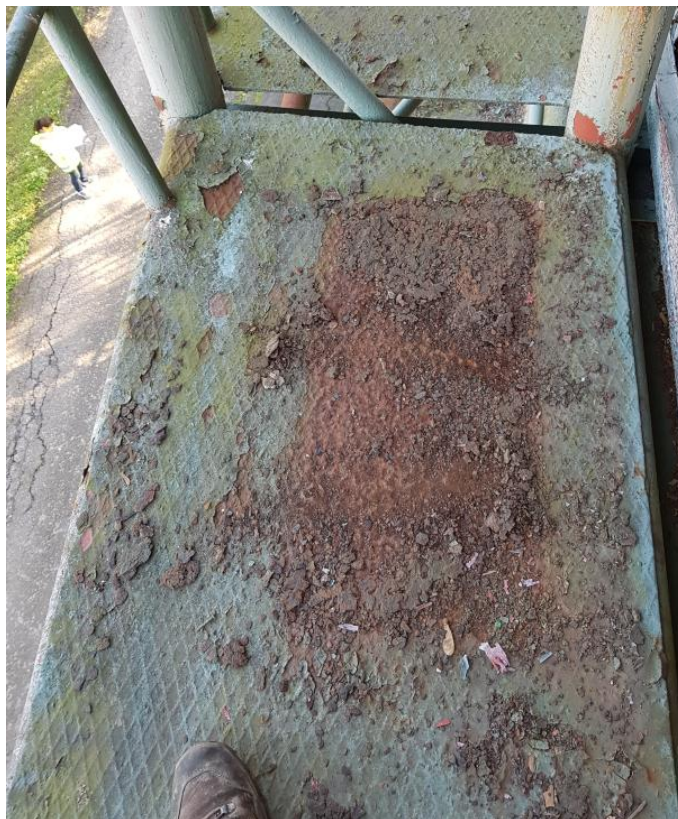
Obr. 8: Korozí pochozího plechu servisní lávky
