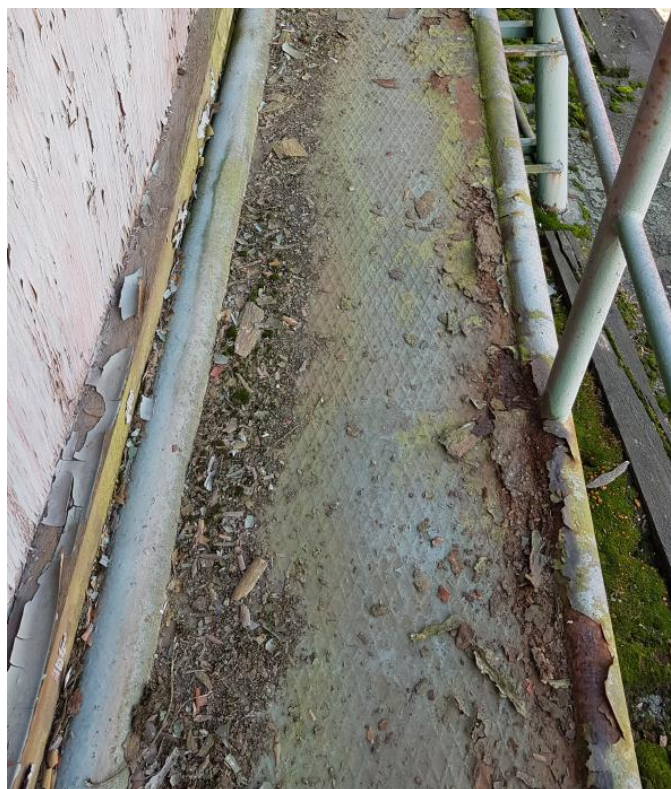
Obr. 7: Méně znečištěná část servisních lávek avšak s korozním poškozením
