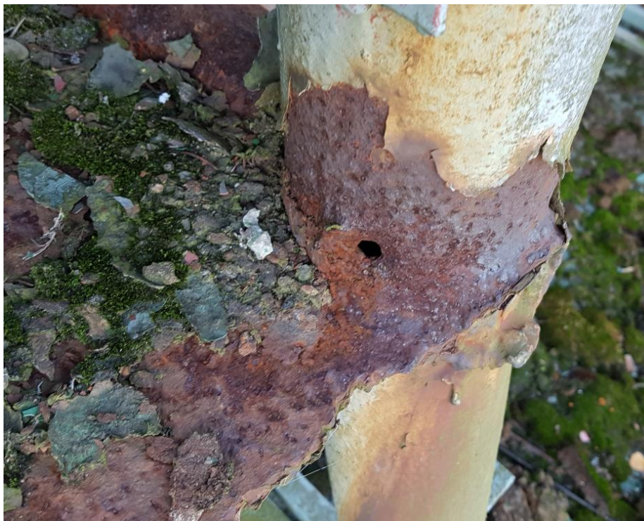
Obr. 12: 100% korozní poškození sloupu v místě napojení horizontálních prvků servisní lávky
