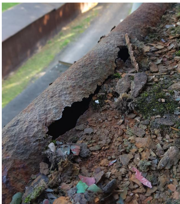
Obr. 9: 100% korozní poškození trubky
