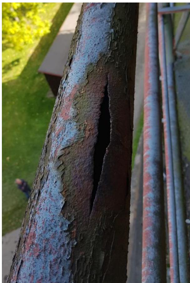
Obr. 13: Mechanické poškození (perforace) prvků
