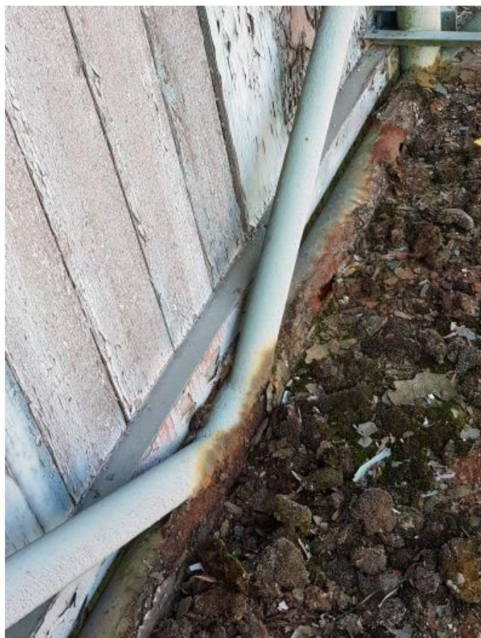
Obr. 11: Další příklad korozního poškození, v některých místech i 100% korozního úbytku
