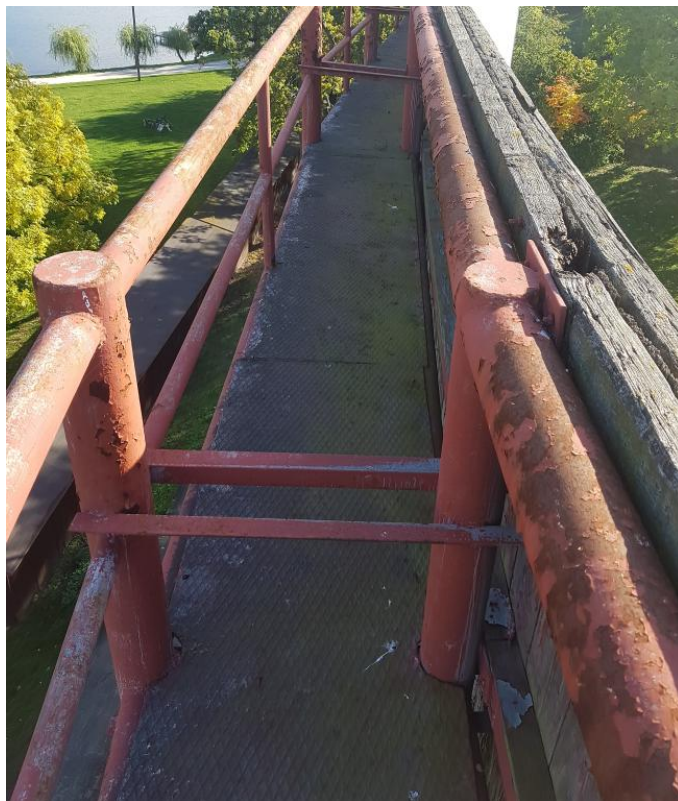
Obr. 4: Horní servisní lávka – poškozená PKO na trubkách
