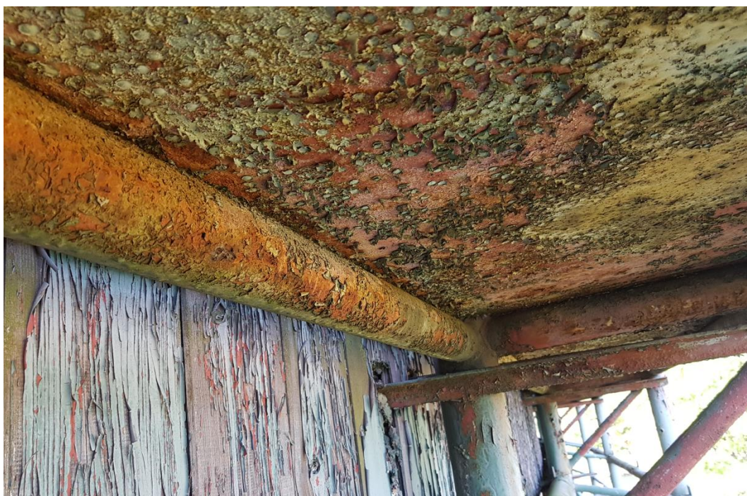
Obr. 5: Poškozená PKO na nosných prvcích i pochozím plechu servisní lávky
