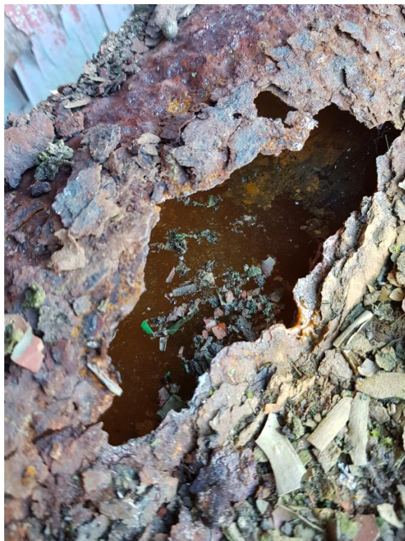
Obr. 10: Chybějící části stěny trubky pronikla voda, která se v profilu hromadí
